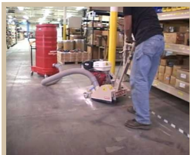
Sierra de grietas
